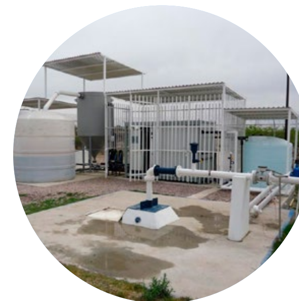
Mexikó Aguascalientes Arzén eltávolítása 36 m 3 /h (4 db)
