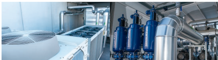
Hűtőtornyok / Cooling Towers
