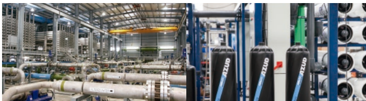
Tengervíz sótalánítás / Seawater desalination
